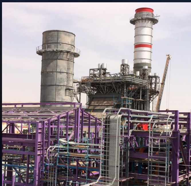
ICL 240MW Power st., Dead Sea
